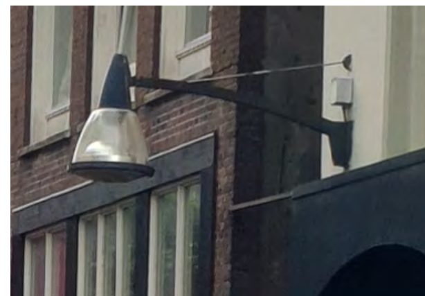
Handhaven verlichting aan de gevels
